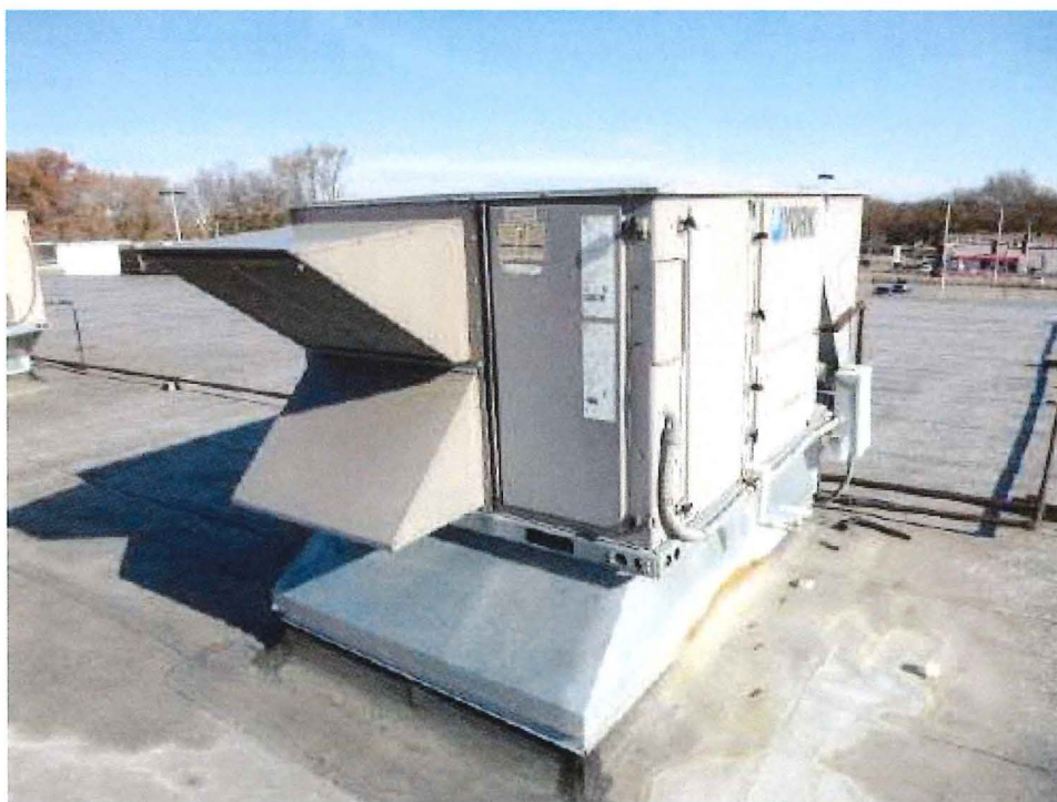
4420 S Noland Rd – RTU
