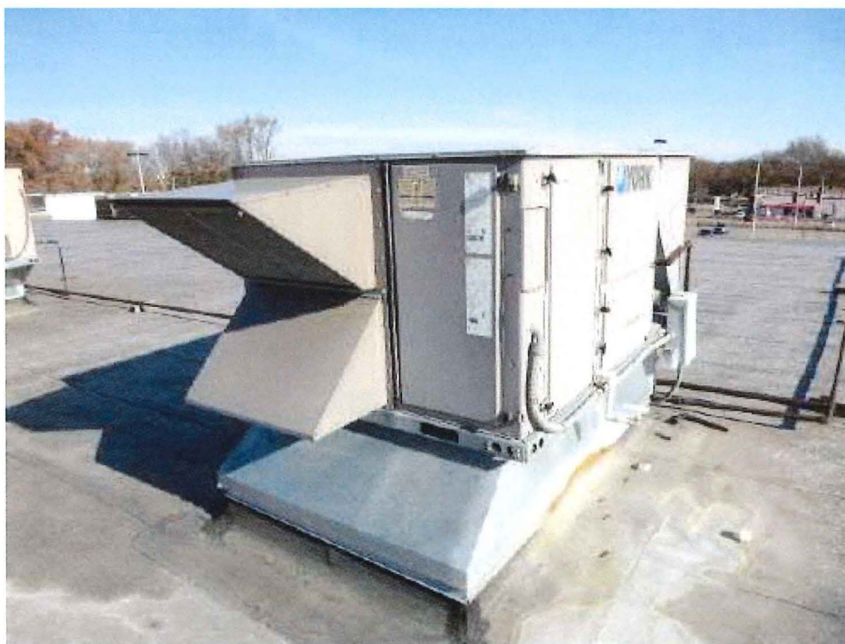
4420 S Noland Rd – RTU
